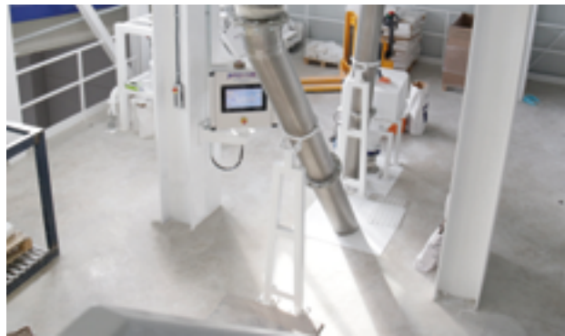
2. Dosificación de materias primas mayoritarias. Dosing of main raw materials.
