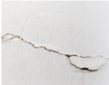
Fisuras profundas Deep cracks
